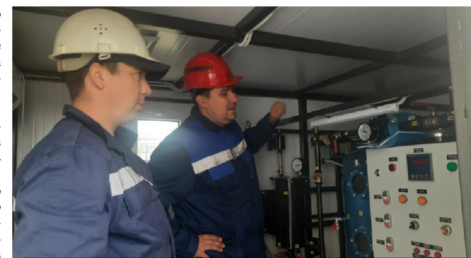
В этом году предприятие приобрело установку для фильтрации и осушки трансформаторного масла – УФОМ
