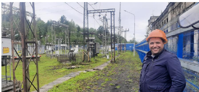
В ходе посещения энергоучастка, главный инженер «Мамско-Чуйские электрические сети» ОГУЭП «Облкоммунэнерго» Данил Хафизов рассказал о внедрении современных технологий на подстанции, направленных на повышение производительности и обеспечение бесперебойности работы всего энергетического комплекса района
