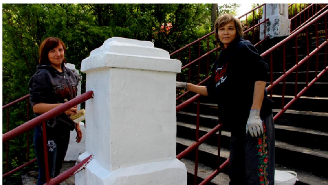
Женская часть подрядной бригады по благоустройству пристани Наталья Баймлер и Тамара Анишуква обновляют фасад лестницы
